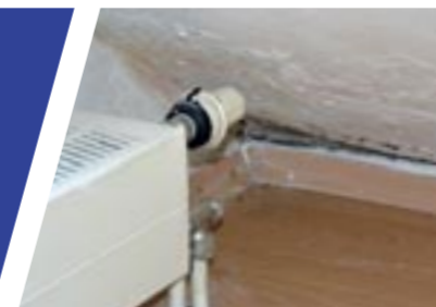
Rechts: Wasserschäden mit der Folge von Schimmelpilzbefall bedingt durch eine Leckage an der Heizung
